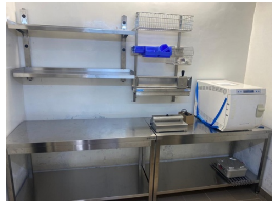
Der fertiggestellte Inspektions- und Packtisch mit einem kleinen Autoklaven.
